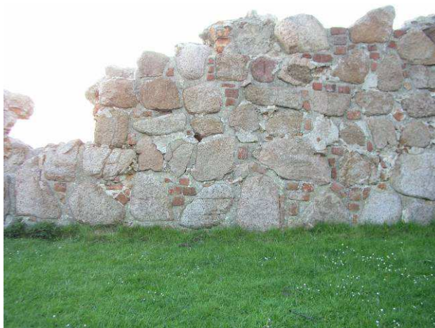
Skibets nordmur med løse fuger
