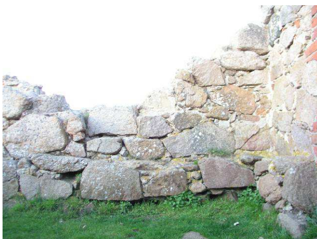
Våbenhusets vestvæg med muret bæk, løse sten og fuger
