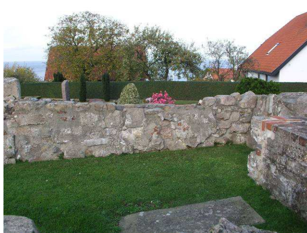
Nordmur med revner og løse fuger
