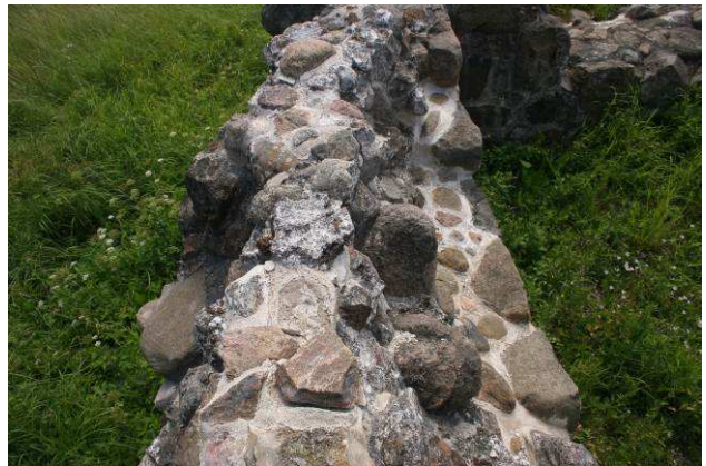
Løse og manglende sten på østmurens murkrone.
