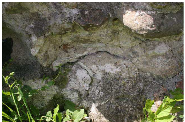
Revne mellem sten og mørtel i østmurens yderside.
