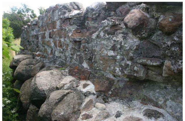
Nordturens yderside med rester af facadens teglsten.
