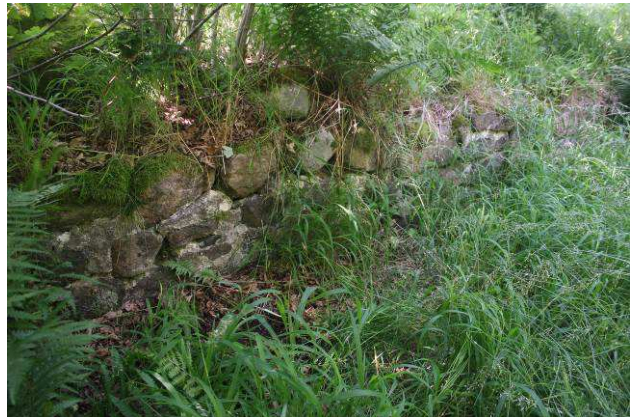
Murværk med løs og nedbrudt mørtel og manglende kiler.
