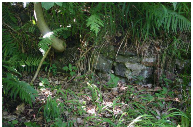
Murværk i opløsning.
