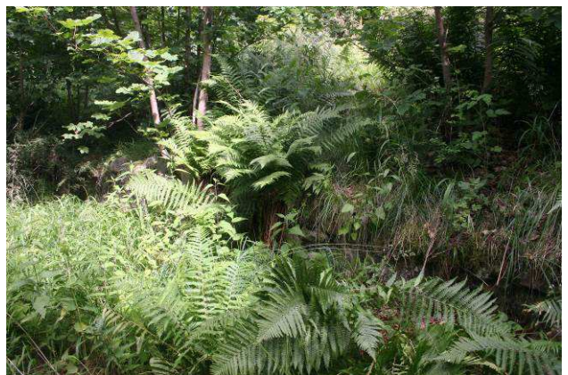
Kældermurene er mange steder stærkt tilgroede og svære at se.
