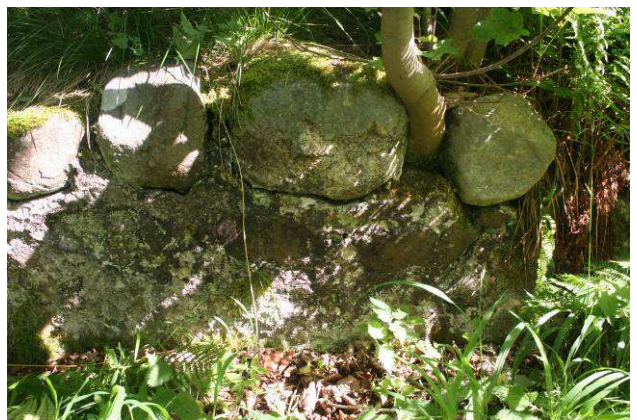
Træer sprænger murværket og skal holdes væk fra ruinen.
