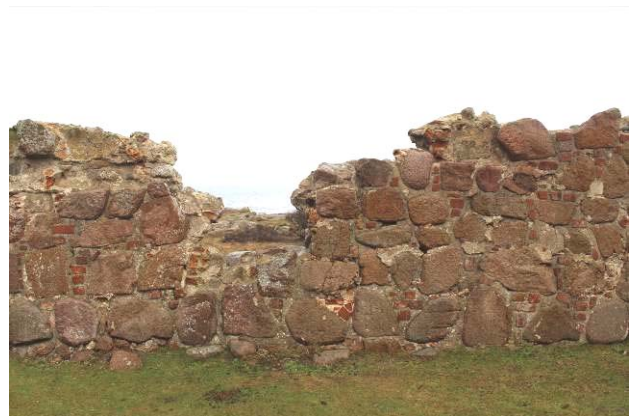
Skibets nordmur med løse fuger
