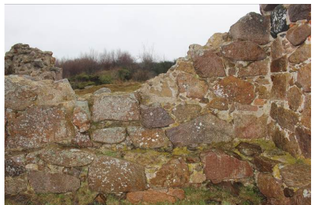
Våbenhusets vestvæg med muret bænk, løse sten og fuger
