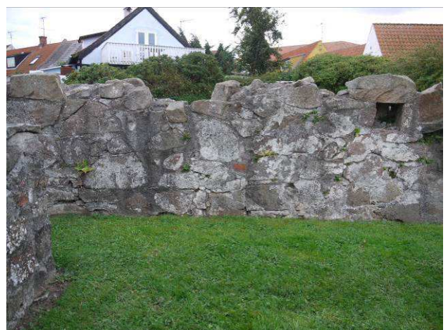
Syd mur med spor af kalkmaleri, løse fuger
