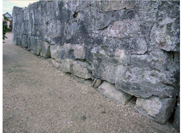
Korets nordmur nedbrudt af cementfugning
