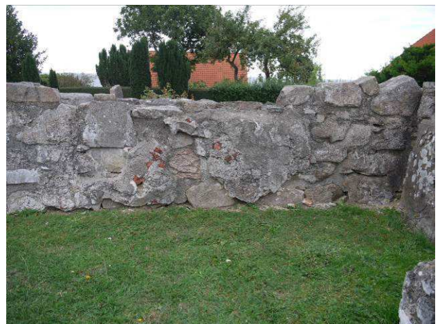
Nordmur med revner og løse fuger
