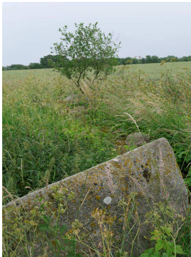
En stor del af murværket er i opløsning med løse sten.
