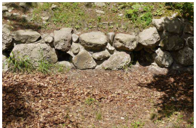
Manglende sten i murværk
