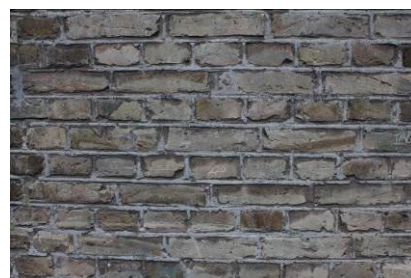
Murværk med brændte fuger.
