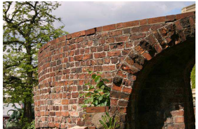
Trævækst i murværket
