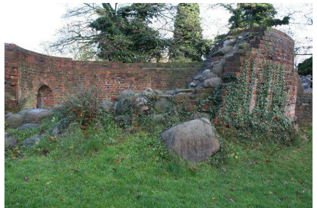
Buske og anden vedvækst på og i murværket
