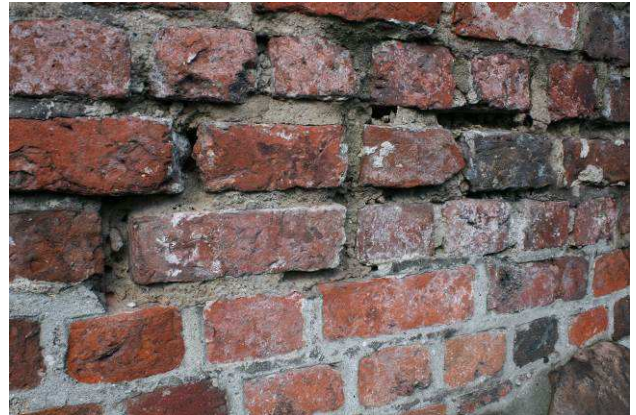
Nedbrudte fuger i tårnets ydermur
