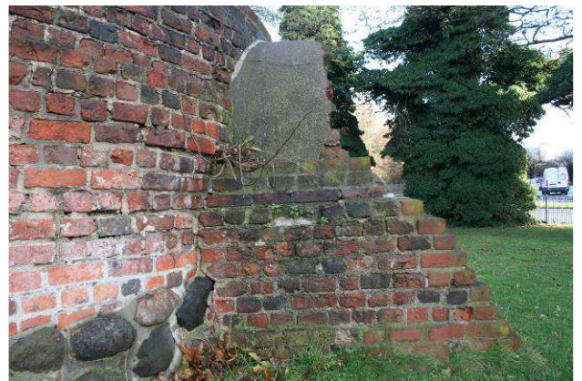
Vedplante i murværket. Revner og nedbrudte fuger
