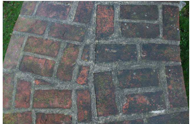
Revner i murkronens afdækning
