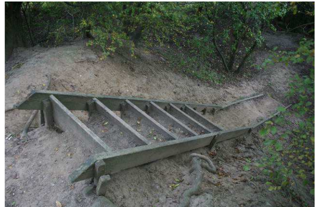
Trappen i voldens sydvestende er ødelagt og terrænet omkring eroderet kraftigt.
