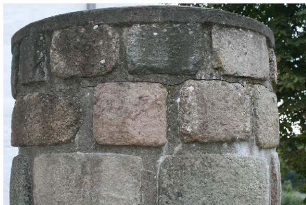
Søjlels øverste lejefuge og afdækning er revnet.
