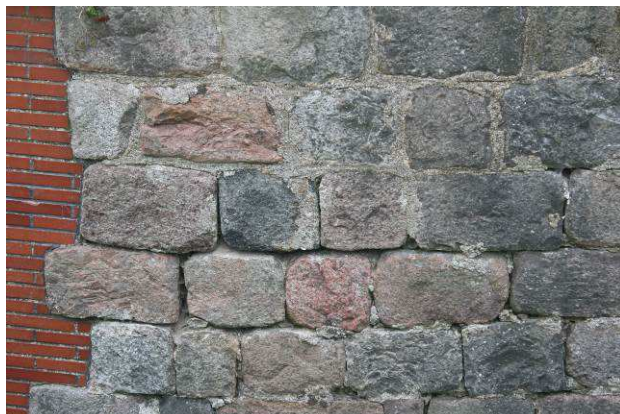
Murens fuger er flere steder nedbrudt til stor dybde.
