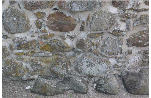
Fugeskader på hjørnetårnet
